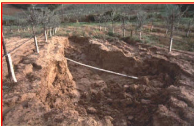
Un grosso fosso si è sviluppato dopo il livellamento, a causa dello scorrimento dell'acqua sul terreno incoerente accumulato con il bulldozer
